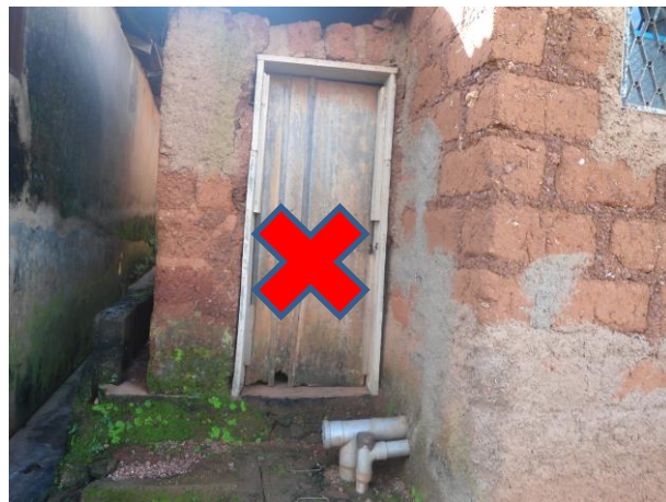
b) Fosse à l'entrée une latrine pleine
