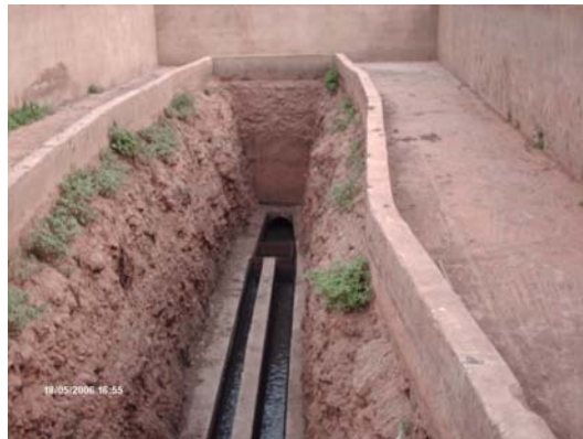
Figure 25: Bassin de Dessablement
