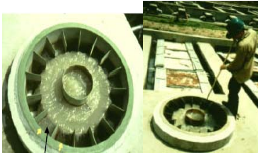
Figure 45:Nettoyage des entrées (UASB)
