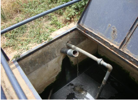
Sortie de l'effluent final des réacteurs de la série gauche
