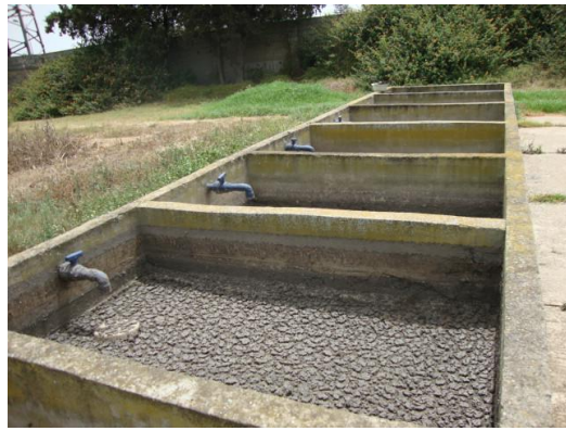
Lits de séchage des boues
