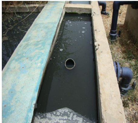
Sortie de l'effluent du décanteur
