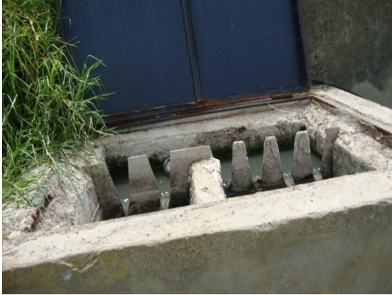
Déversoir de répartition des eaux usées
