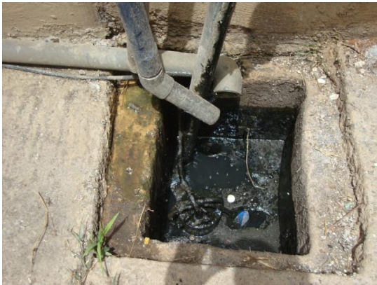
Regard d'évacuation de boues
