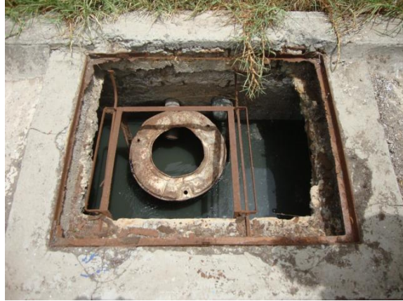
Système de dégrillage des eaux usées (pendant le pompage)
