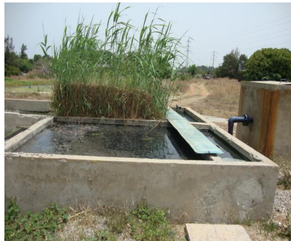
Filtre à gravier horizontal
