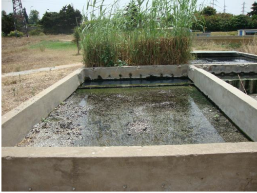
Filtre à gravier vertical
