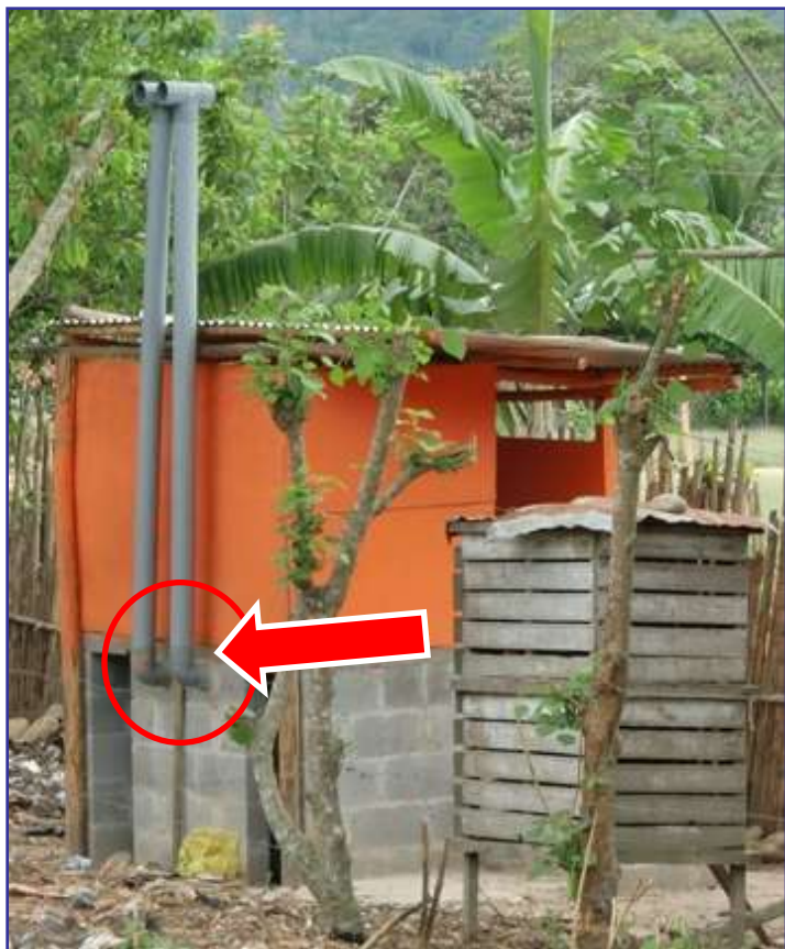
Tubos de aeración con codo de 90° ERRADO
