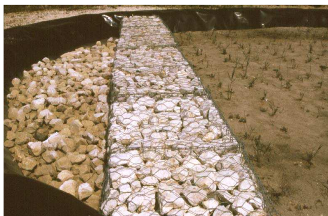
Figura 20. HFH con dique de piedras en la zona de entrada que ayuda con la distribución e infiltración del agua a tratar, cerca de Leiria, Portugal (foto J. Vymazal, 2003).
