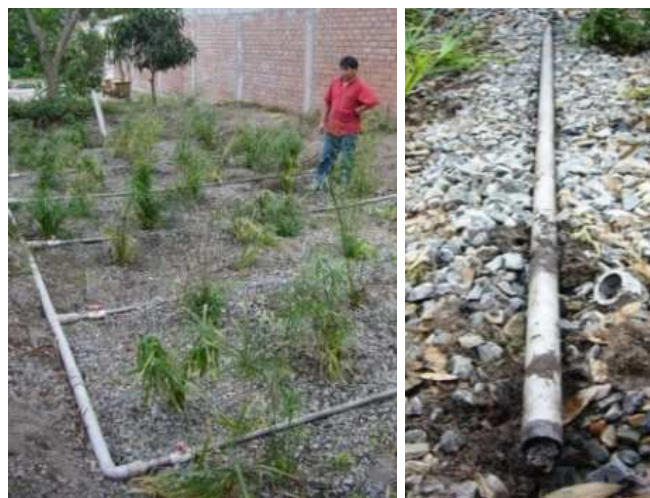
Figura 29. Izquierda: Limpieza de las tuberías de distribución de agua residual por medio de la apertura y cierre de válvulas durante la fase de bombeo (plantas de papiro paraguá después de un proceso de replantado). Derecha: Tapa abierta en una tubería de distribución obstruida (fotos H. Hoffmann, 2009, Lima, Perú).
