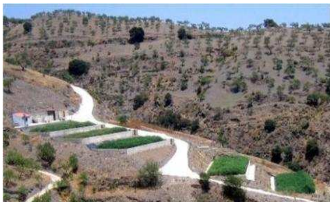
Figura 24. Sistema Francés para 800 PE, de izquierda a derecha: tres HFV (filtros) para el pretratamiento y dos HFV para el tratamiento secundario en Albondón, España. La planta no necesita suministro de electricidad, ya que está construida en pendiente (foto T. Burkard, AKUT, 2005).
