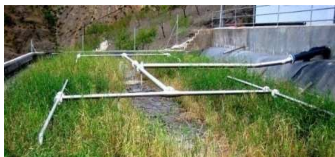
Figura 26. Tuberías de distribución de las aguas residuales sobre el lecho de pretratamiento del sistema Francés, Albondón, España (foto T. Burkard, AKUT, 2007).
