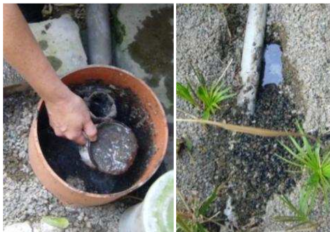
Figura 28. Izquierda: Mal funcionamiento de la trampa de grasa con acumulación de lodos en exceso. Derecha: los lodos de la trampa de grasa obstruyen la zona de infiltración del HA, el color negro se da porque no hay transporte de oxígeno lo que lleva a la obstrucción (fotos H. Hoffmann, 2009, Lima, Perú).
