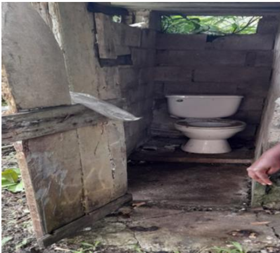
Figure 5: Pour flush latrine (Source:Jodian/Org./2022).
