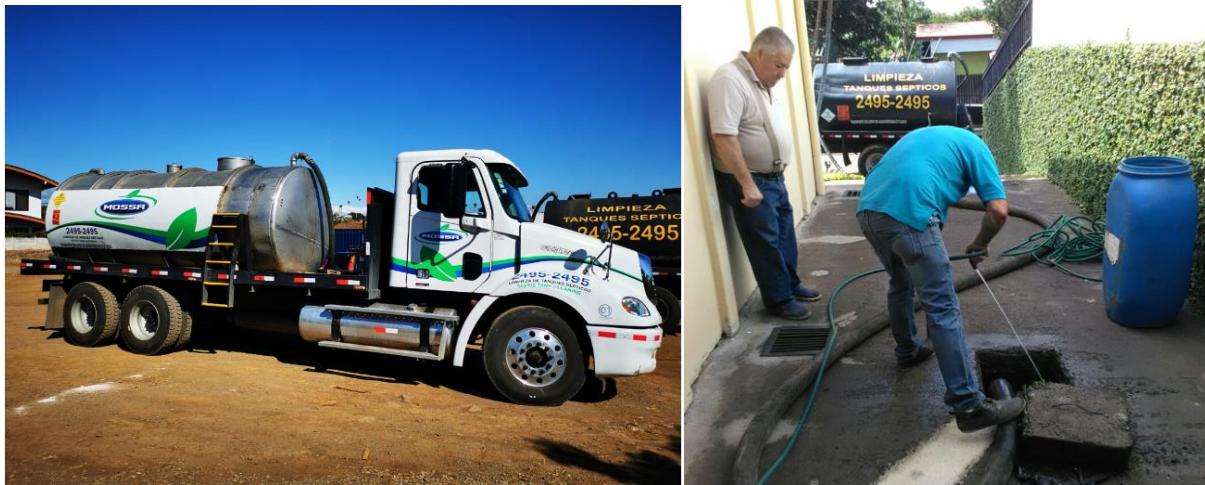
Figura 6: Servicios de limpieza de tanques sépticos.
