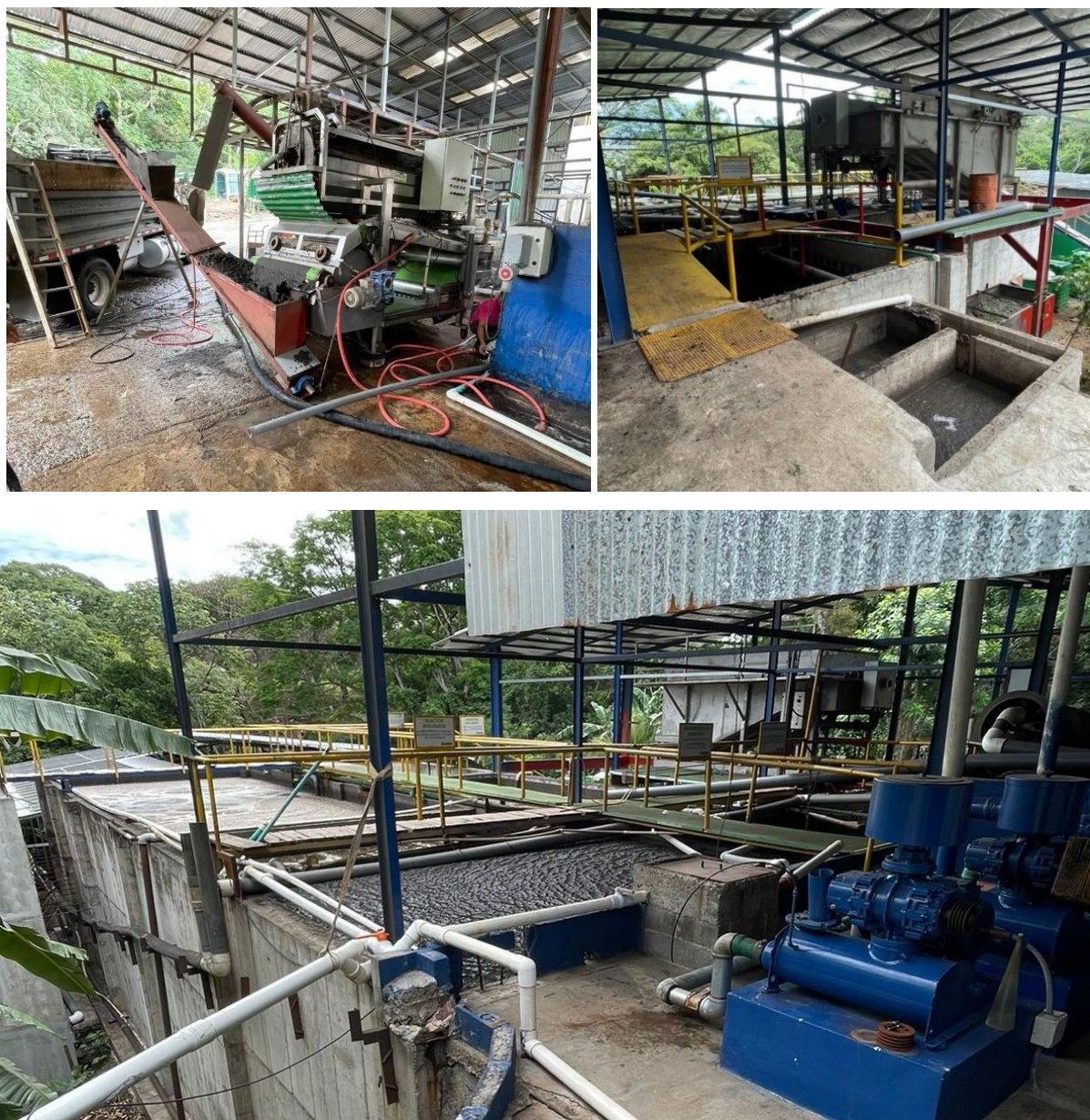
Figura 8: Planta de tratamiento de LF. Compañía de Aguas Sanitarias. Fuente: Compañía de Aguas Sanitarias (2022).
